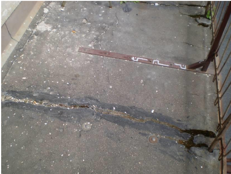
Kuva 11. Terassien kaiteiden kiinnitys laattaan on heikentynyt. Yläpinnan valuasfaltissa on vuotavia halkeamia (kuva vuodelta 2009).
