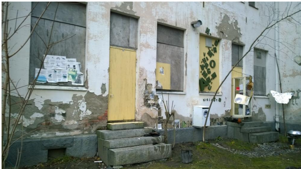
Kuva 9. Ikkunat on levytetty umpeen.
