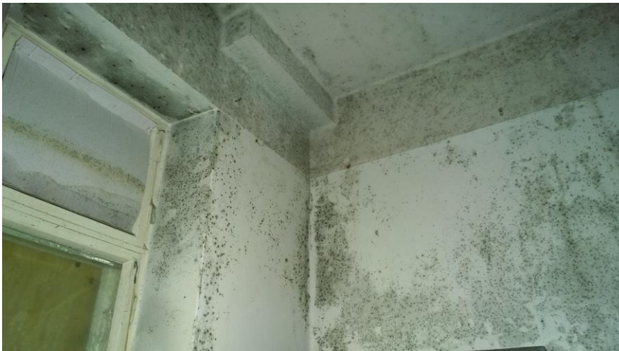
Kuva 18. Homehtuneita pintoja 1. kerroksen pohjoispään huoneissa.
