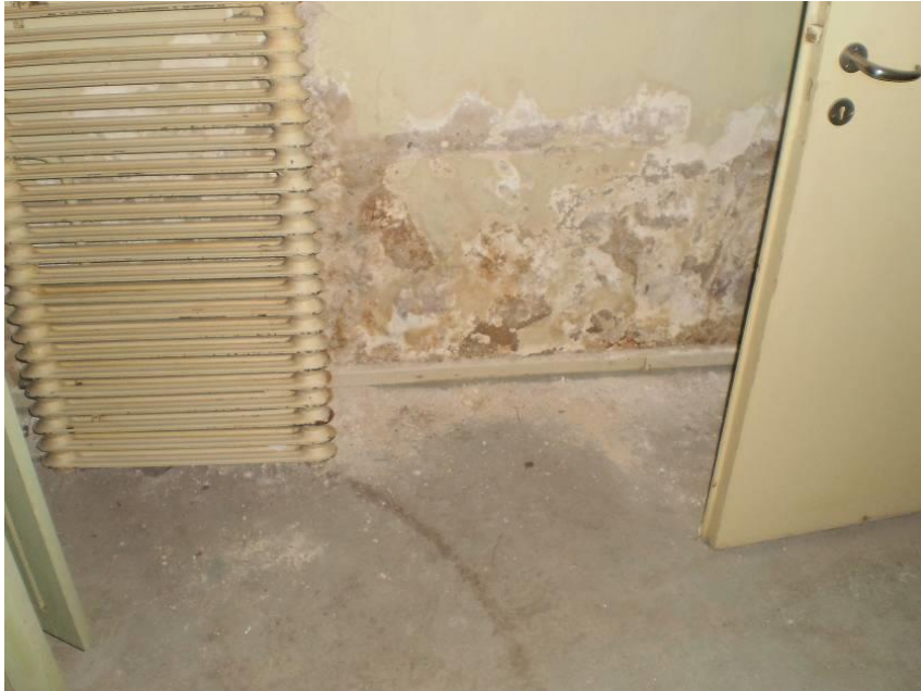
Kuva 1. Kellarin seinässä on kosteusvaurioita.
