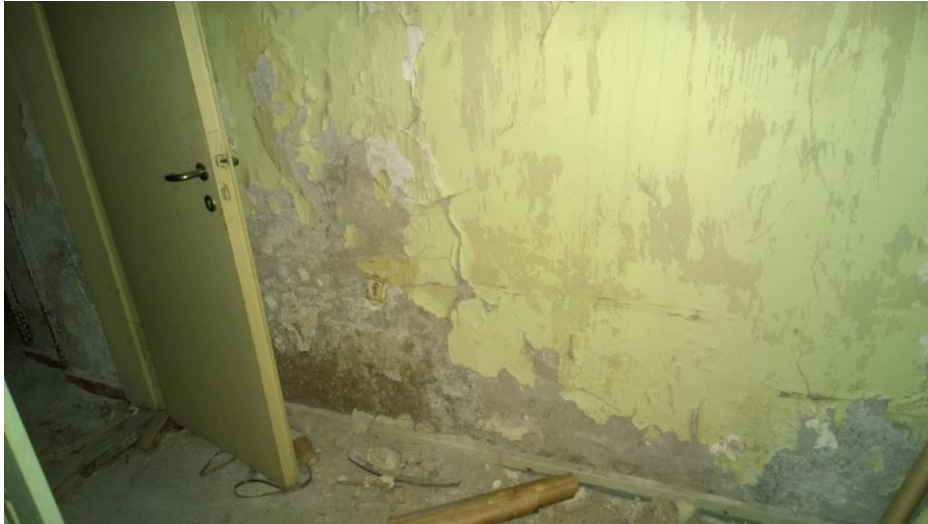
Kuva 3. Lämpöjohtokanavan vastaisen muurin alaosassa on kosteusvaurioita.
