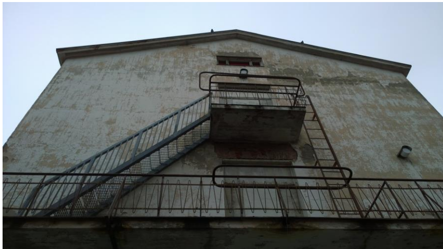
Kuva 7. Rappauspintojen rapautumista rakennuksen pohjoispäädyssä.
