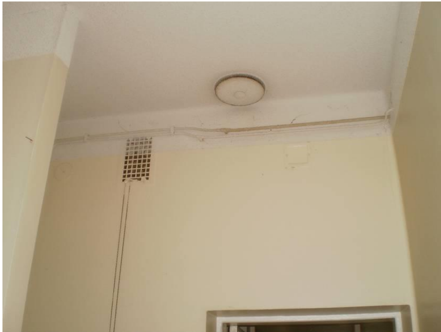
Kuva 34. Painovoimaisen ilmanvaihdon tulo- ja poistoventtiili.
