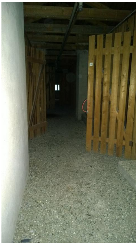
Kuva 14. Ullakon lattialla on runsaasti lintujen ulostetta.
