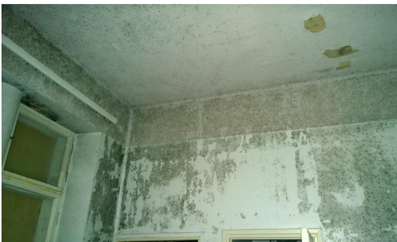
Kuva 20. Seinät ja kattopinnat ovat kostuneet ja homehtuneet puutteellisen ilmanvaihdon takia.
