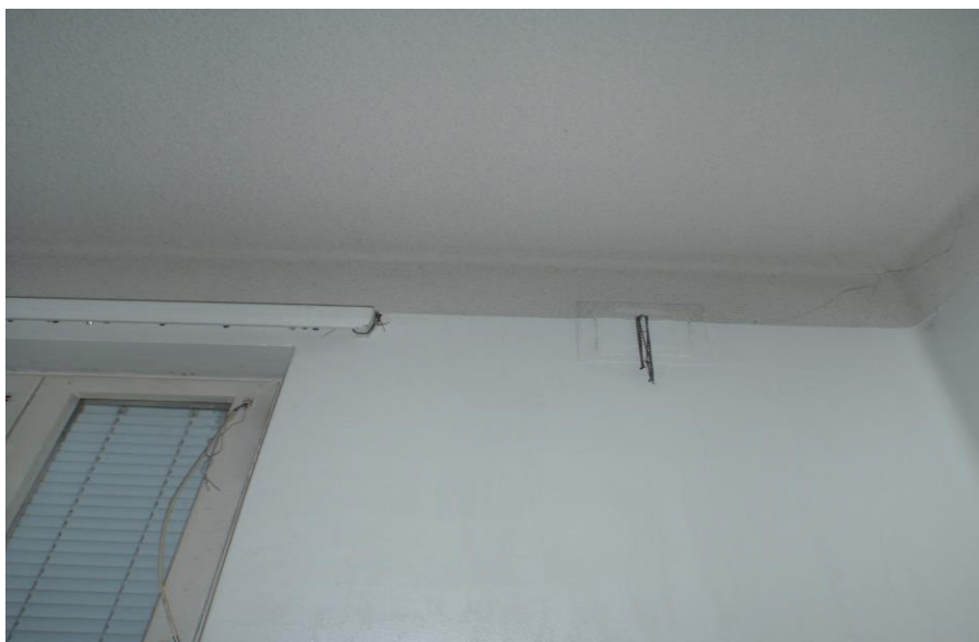
Kuva 35. Painovoimaisen ilmanvaihdon tuloilmaräppänä.
