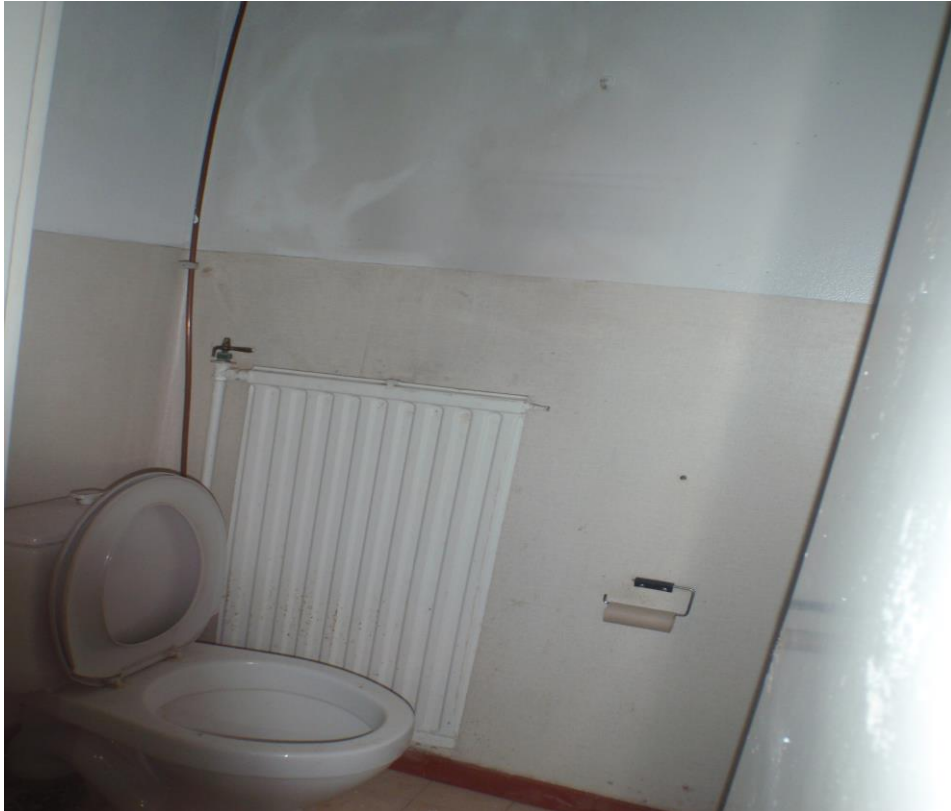
Kuva 32. Levypatteri ja vanha patteriventtiili
