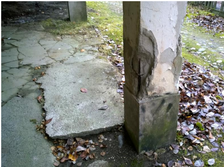
Kuva 13. Pohjoispäädyn pilareissa on voimakasta teräskorroosiota ja rapautumaa.
